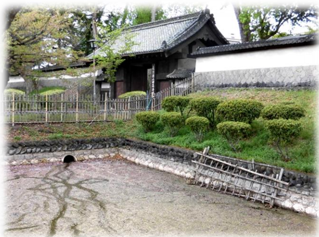
漏水のため干上がったお堀
